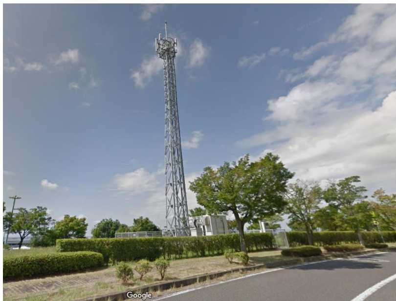
NTT移動通信用基地局設備
