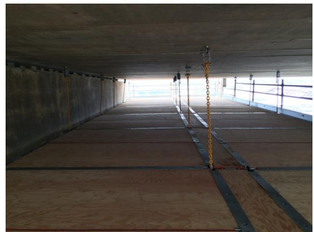
写真一 6 吊元が少なくチェーンピッチが長い
