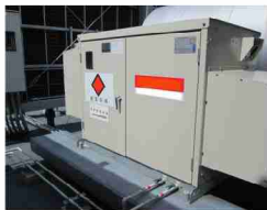
屋上に設置した非常用自家発電設備
