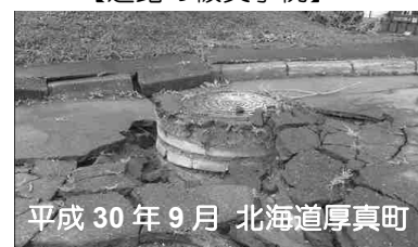
【道路の被災事例】
