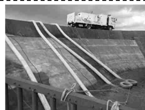
移動式排水施設による排水
