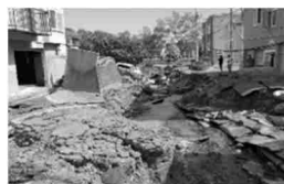
札幌市の液状化による被害 (北海道札幌市)
