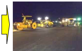
(老朽化した滑走路舗装の改良)
