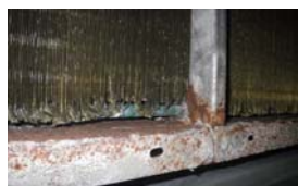
塩害で腐食した ラジエーター
