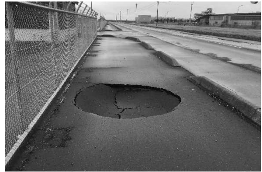
苫小牧港の陥没状況
