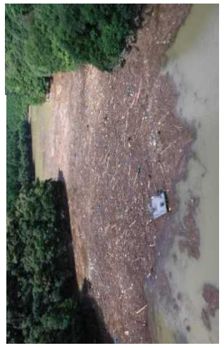
野村ダム流木堆積状況
