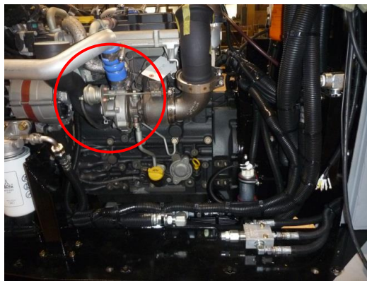
機関室内部写真
