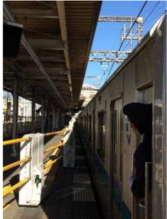
昇降バー式ホーム柵（視認性改良型） (改良後：バー降下時)
