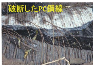
PC管の劣化状況
