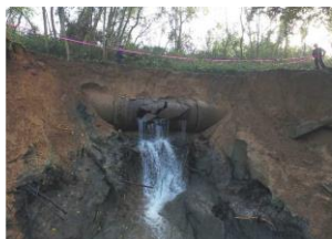
漏水事故の状況
