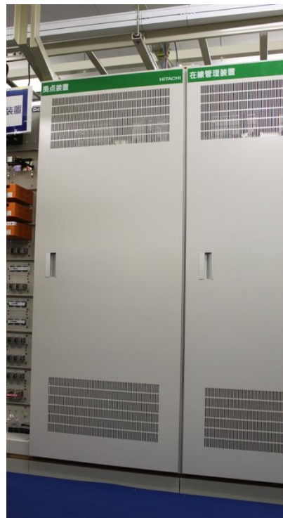
拠点装置 在線管理装置
