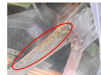
耐候性鋼材に層状の剥離
