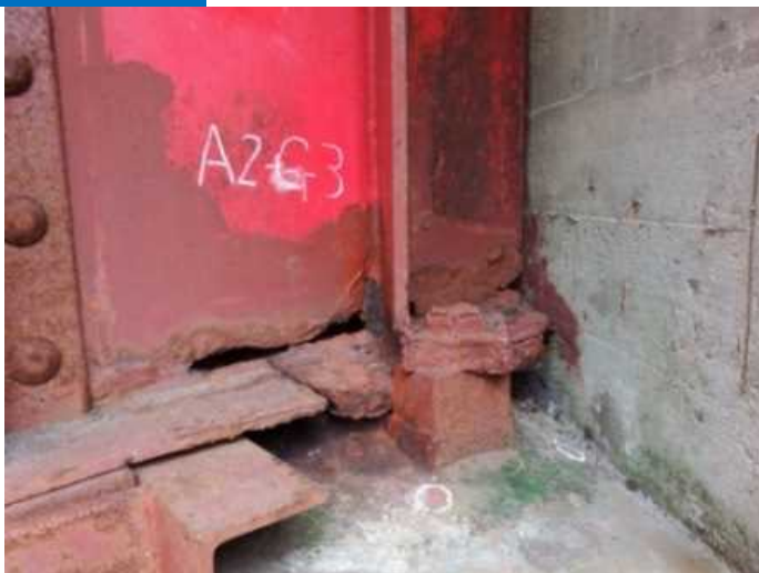
桁端部の腐食・貫通
