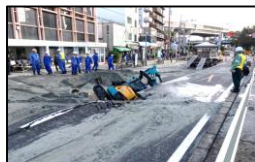
←上下水道等の老朽化に伴う道路陥没
