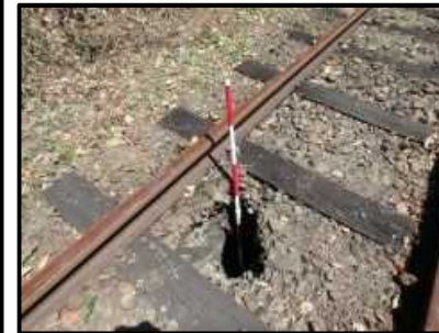
6k250m軌道変状(陥没)
