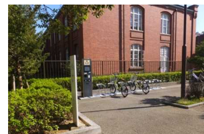
公共施設(図書館)に設置 (金沢市)
