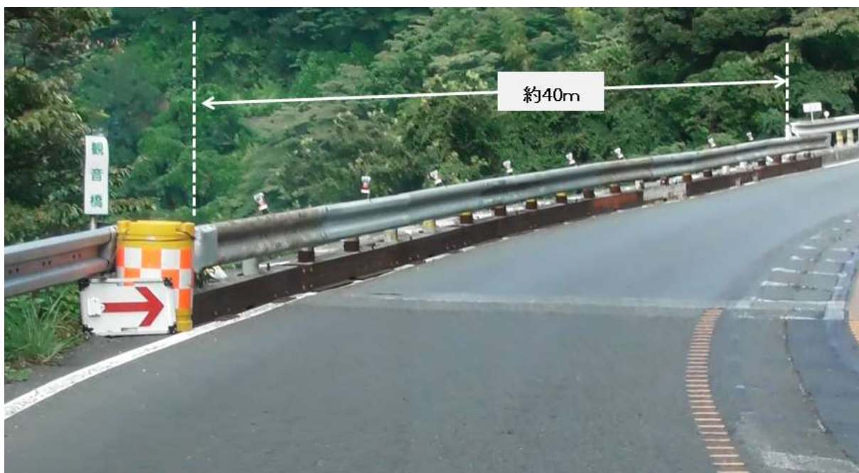
写真2 事故地点（事故後仮設されたガードレール）
