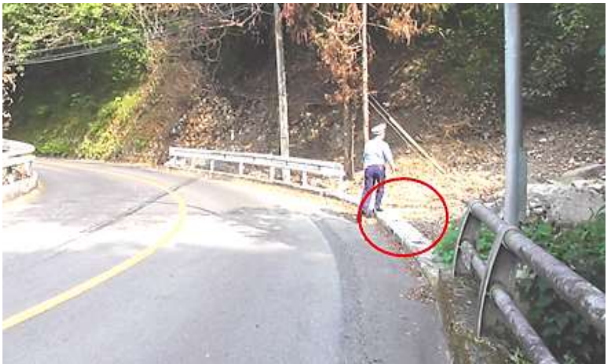
写真4 県道732号線（○は転落地点）
