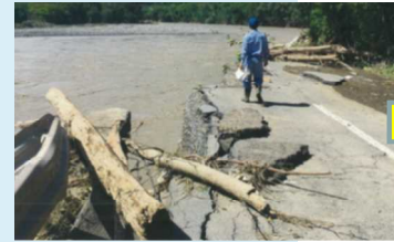
国道455号: 岩泉町乙茂地区: 道路崩壊
