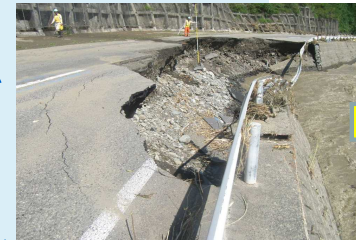
国道106号: 宮古市暮目: 道路崩壊
