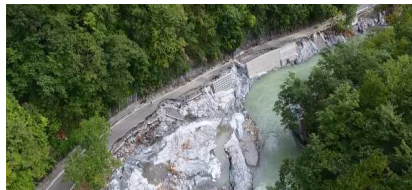
県道普代小屋瀬線: 岩泉町安家 河川による道路崩壊 9/7に専門家が現地調査を実施
