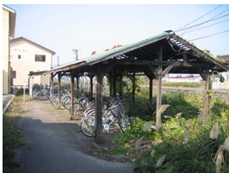
図 1-2-7 老朽化が見られる駐輪場
