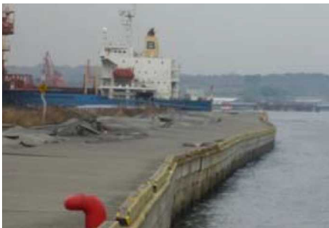
被災事例(はらみ出し)
