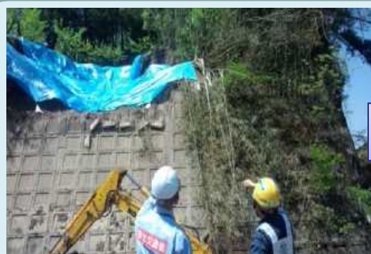
被災状況を現地で調査
