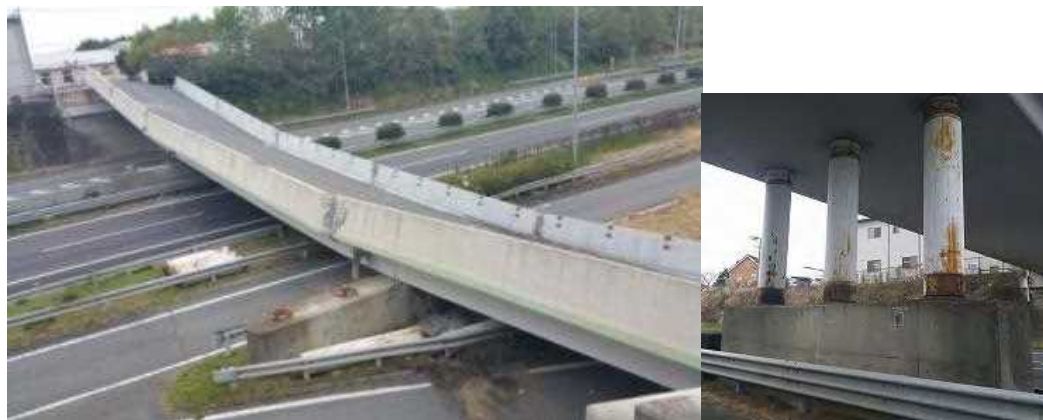
写真-3 跨道橋の落橋 (熊本県道府領第一橋 左:落橋後、右:落橋前)
