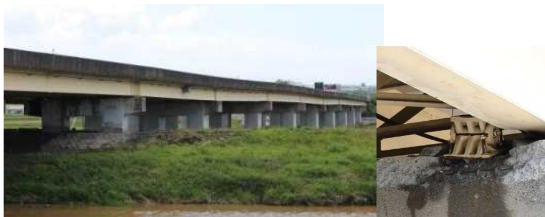
写真-2 上部、下部構造の損傷 (木山川渡河部 木山川橋 左:全体、右:支承部の損傷)
