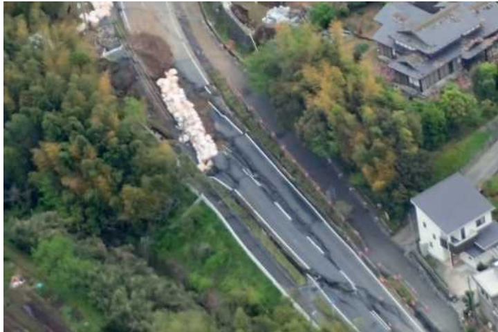
写真-10 盛土の崩壊 (国道443号熊本県益城町内)
