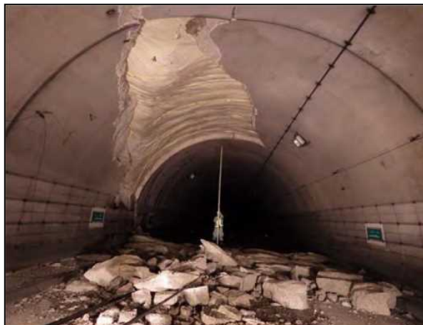
写真-7 覆工コンクリートの崩落 (俵山トンネル)
