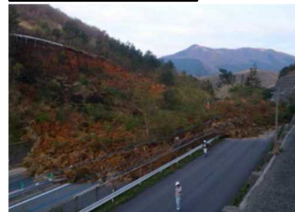
写真-4 切土のり面の崩壊 (由布岳PA付近)
