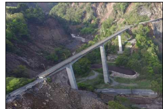
写真-8 橋台の損傷 (阿蘇長陽大橋)
