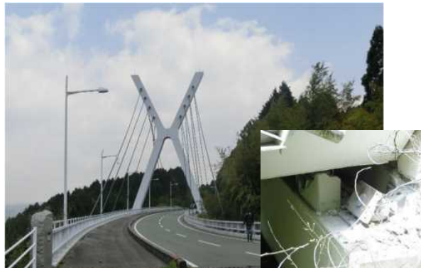
写真-6 支承部の損傷 (桑鶴大橋)
