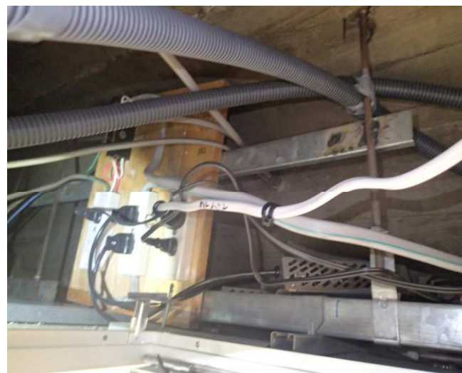
分電盤の取付の安定性不足
