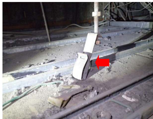
ハンガーの脱落
