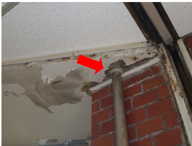
天井の漏水跡
