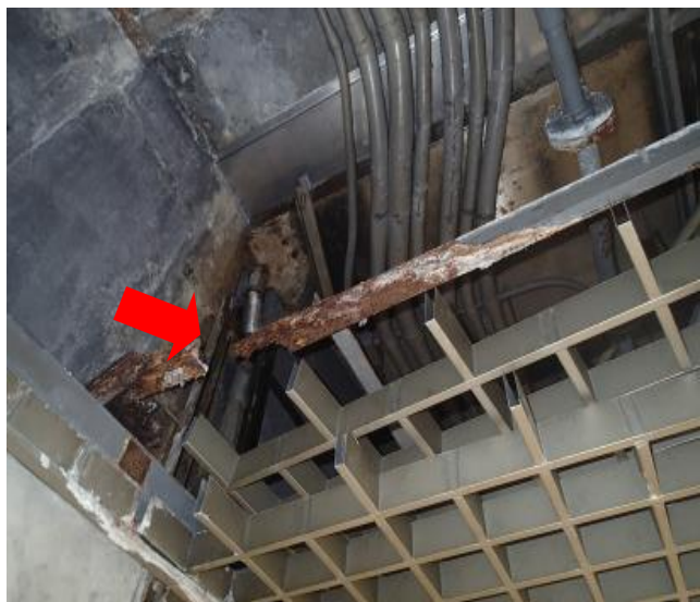
漏水による部材の破断
