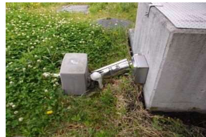
ポンプ設備(井戸水配管)被災状況 ※機能上問題なし。
