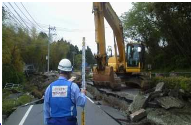
■国道443号(益城町)
