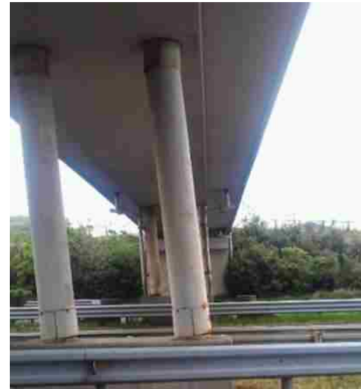
こうぞの ④熊本IC付近 神園跨道橋 橋脚傾斜
