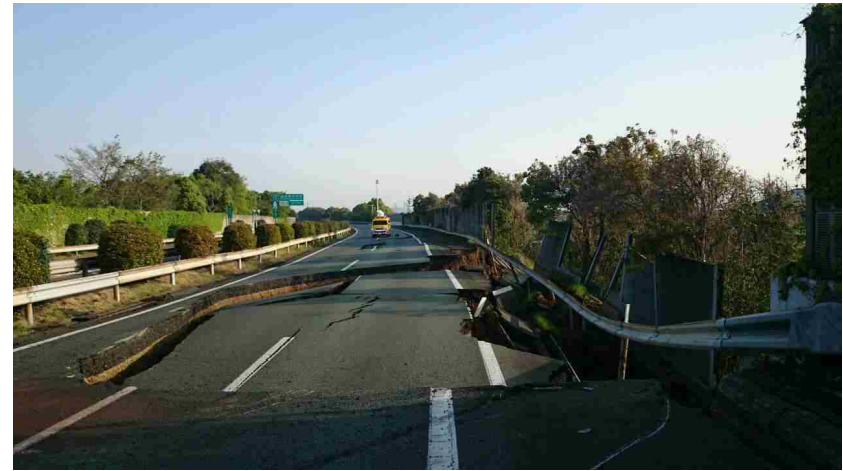
ましき ① 益城バスストップ付近 盛土法面の崩落
