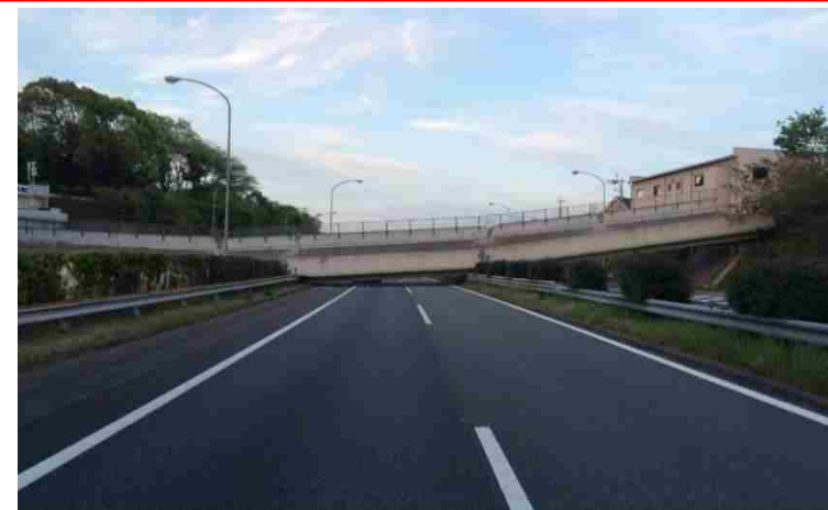
みどりかわ ぶりょう ③緑川PA付近 府領跨道橋 高速道路上に落橋
