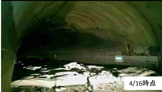
俵山トンネル 覆工コンクリートの崩落(県道熊本高森線)
