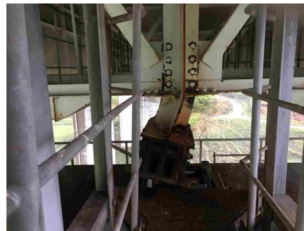
ゆふだけ なみやなぎ ② 由布岳PA付近 並柳橋 桁及び支承損傷
