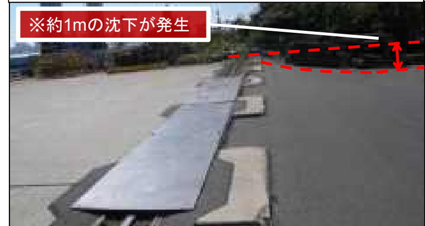
栈橋上部工背後沈下状況(陸上側)
