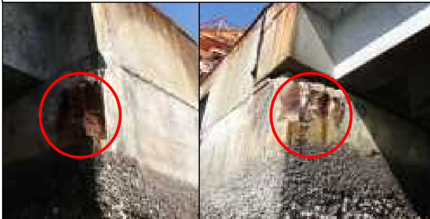
栈橋上部工梁部のコンクリート剥離状況(海上側)
