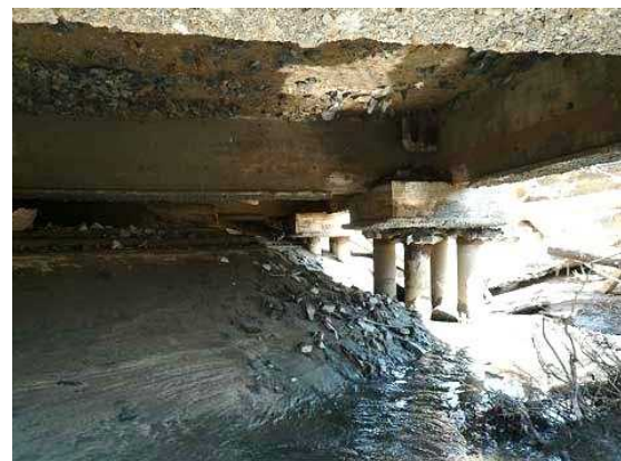
建物基礎が露出
