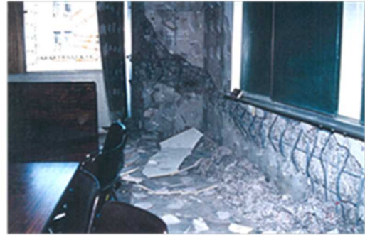
内部の被災状況
