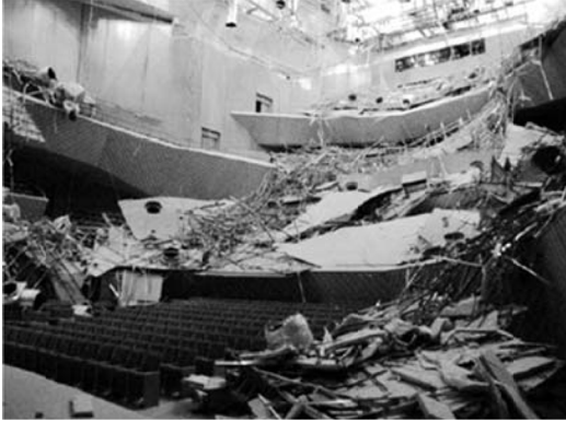
ホール天井の脱落
