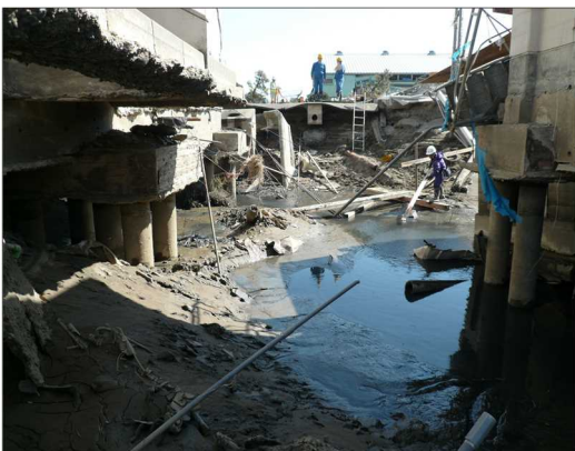
庁舎周囲の地盤流出
