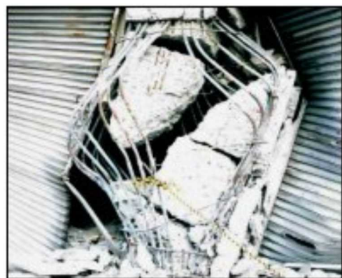
店舗1階柱の圧壊
