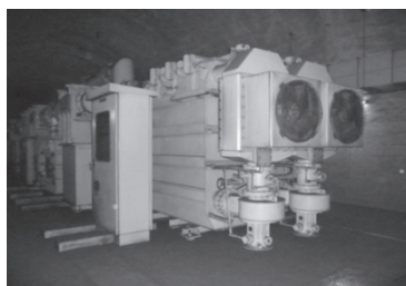
【変電所設備の一例】
