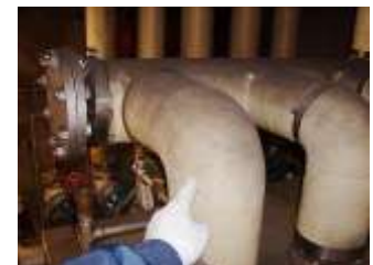
ボイラー配管保温材
