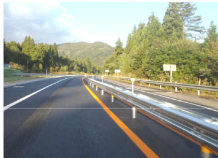
<ガードレール>
