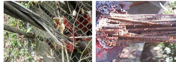
ケーブルの破断状況
