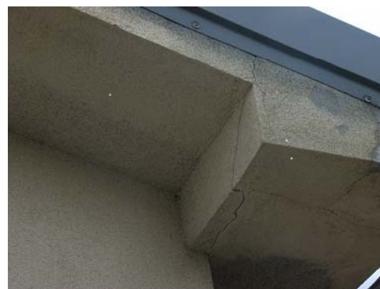
車庫：底に亀裂があり落下の危険性がある
