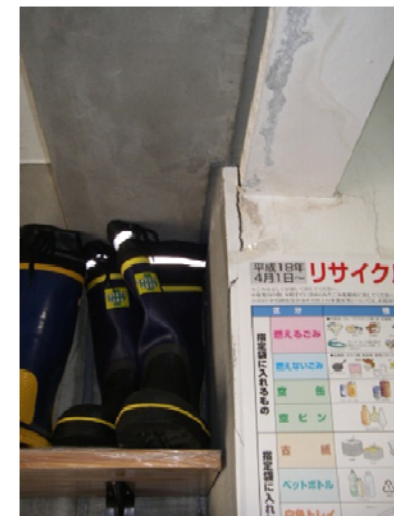
庁舎：内壁にひび割れ、塗装の剥がれが見られる
