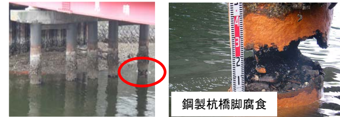
見晴橋(市道 新山下第8号線)は、37歳で損傷を発見
