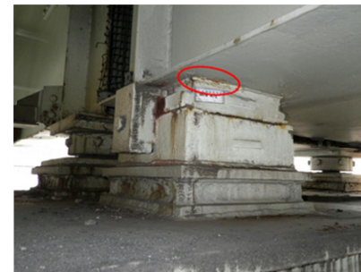
【支承部の疲労き裂】
