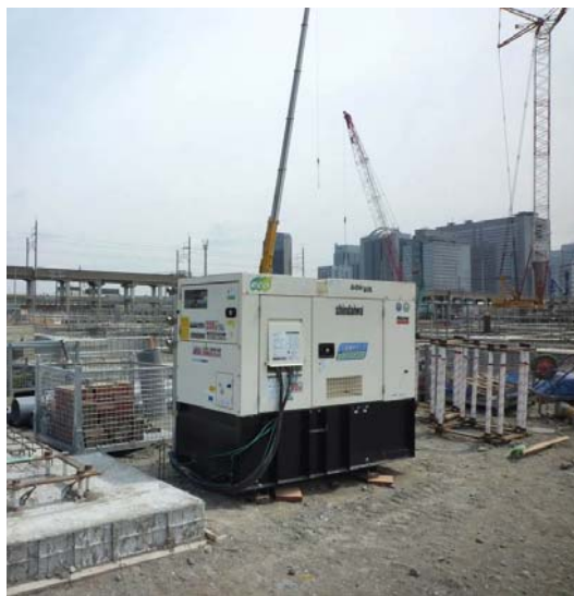
写真二 基礎工事現場の仮設電源
