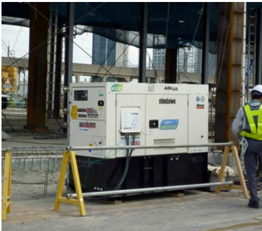
写真一 建築現場の仮設電源
