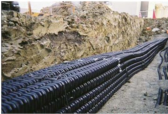
写真-1 多条配管状況
