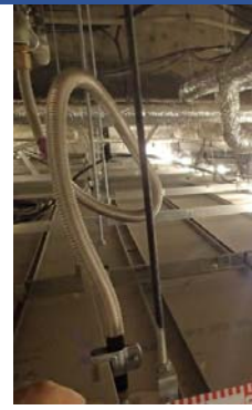
スプリンクラーヘッドをフレキシブル管で接続し、天井と配管の異なる動きに追随
