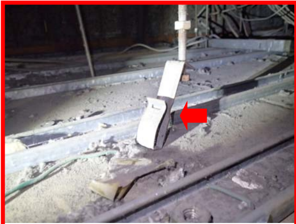
ハンガーの脱落
