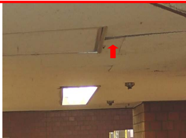
点検口周囲の天井ボードに隙間
