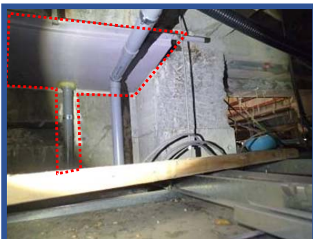
漏水受けパンを設置 →継続的な観察が必要
