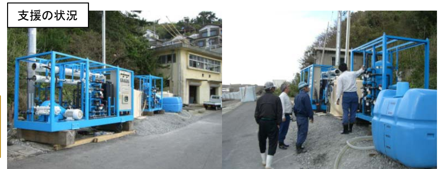
海水淡水化装置設置状況
