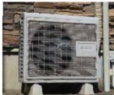
空気熱源ヒートポンプ
