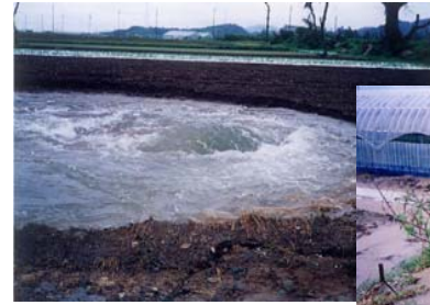
伊良湖サイホン漏水状況
