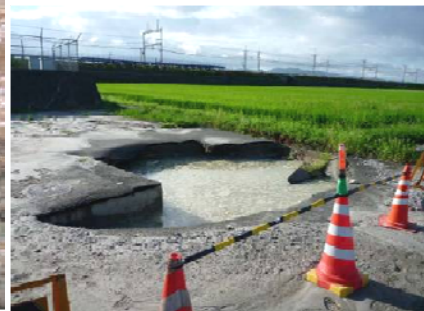
漏水による排泥工周辺陥没状況
