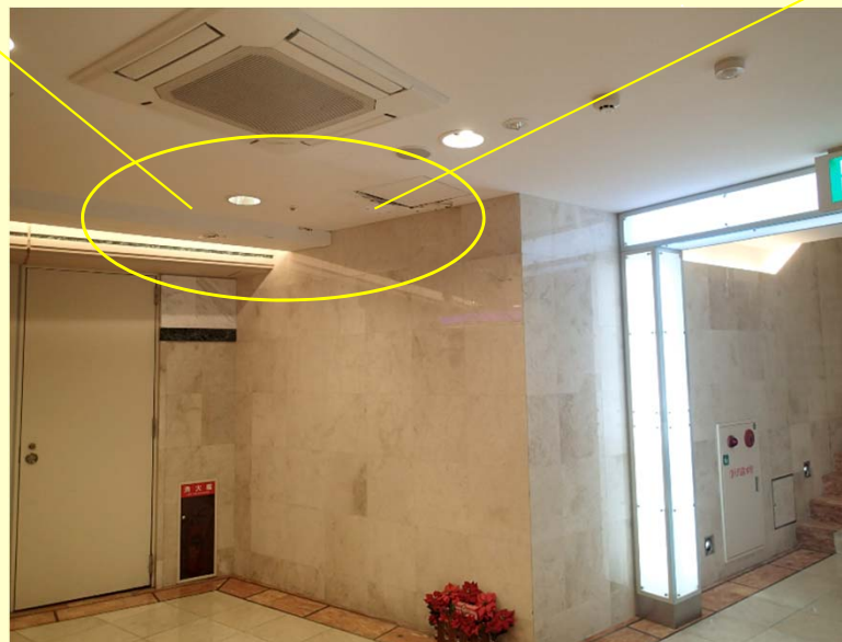
地下街端部階段付近の外観点検で漏水跡がみられる。
