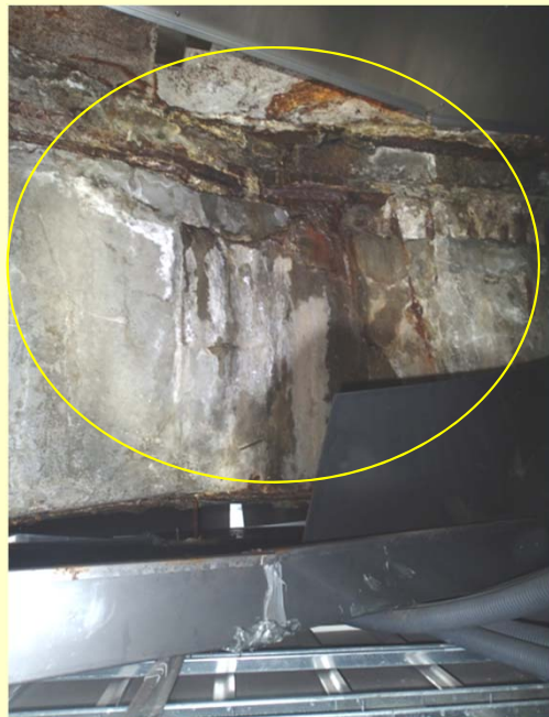
EXP.J廻りの漏水が要因と思われる躯体面の不具合、鉄筋露出。
