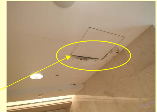
漏水による点検口周りの劣化
