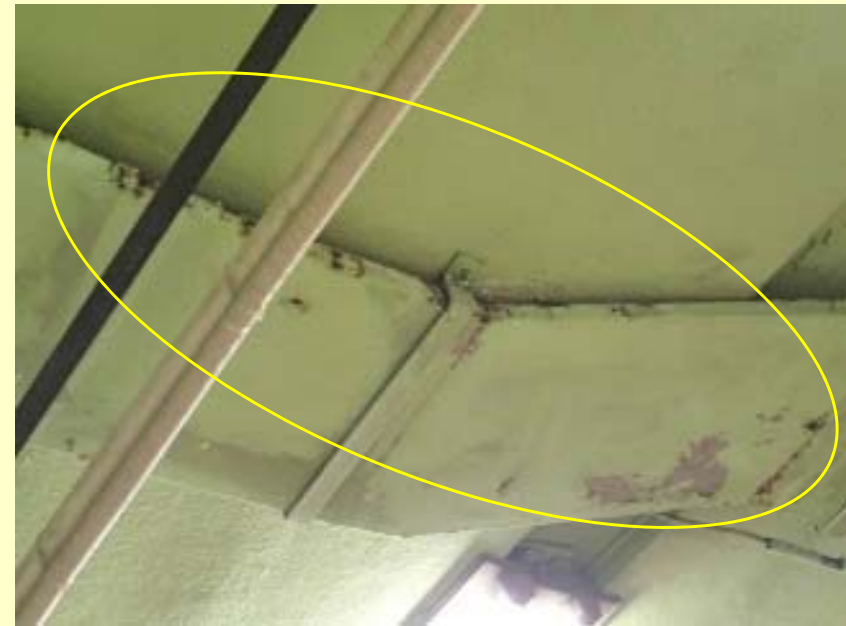
意匠材を吊っていない地下街天井部に設置された防水パンとその周辺に発錆が見られる。
