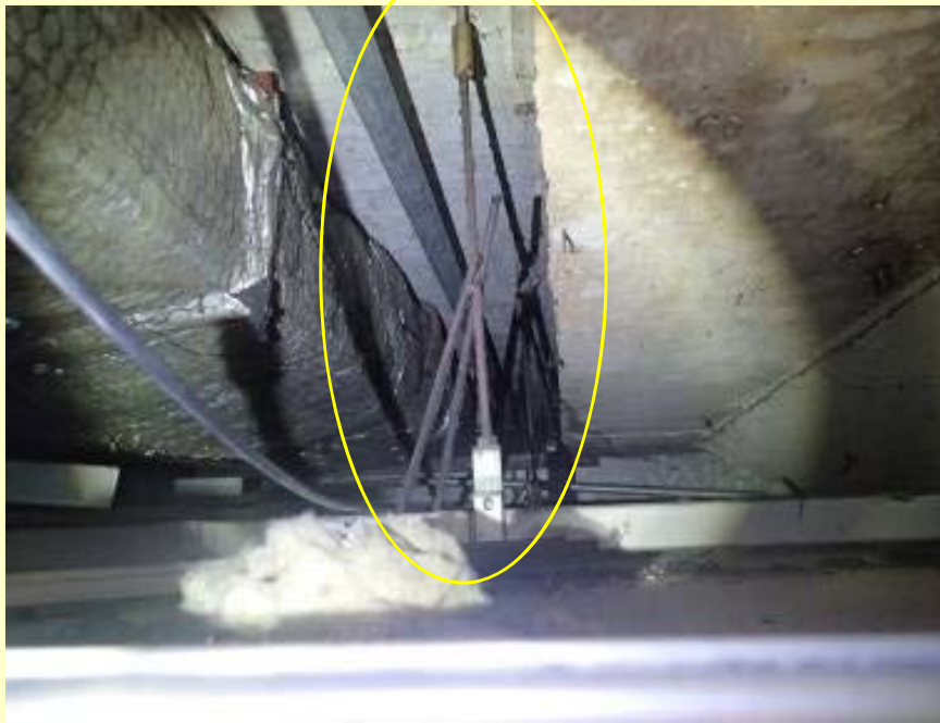
溶接継ぎ足しによる吊りボルトの分岐が見られる。
