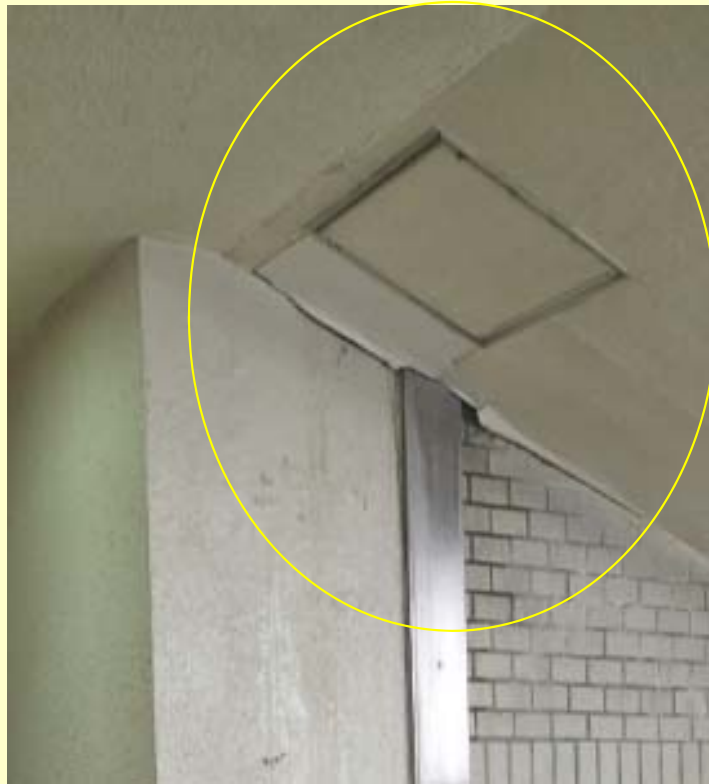
点検口、天井材及び壁廻りに漏水跡が見られる。
