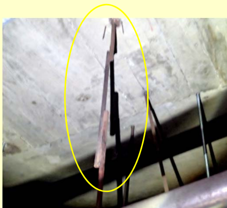
1960年代に施工された天井吊りボルト。2箇所溶接継ぎ足しされている。
