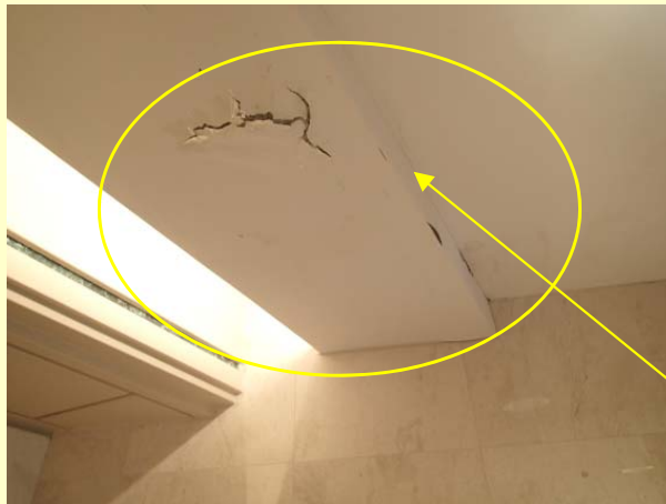
漏水による天井材の劣化
