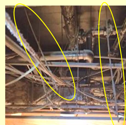
吊りボルトが湾曲されたまま残置されている。
