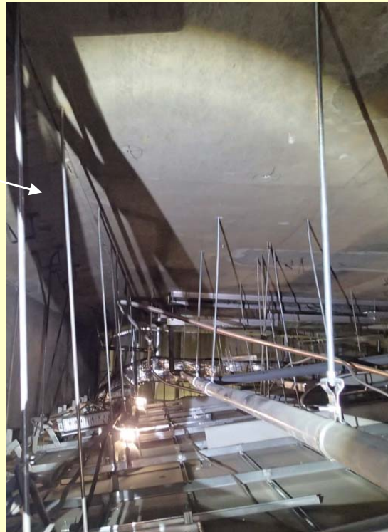
天井内 懐 1.2m 亜鉛メッキ吊り材を使用し、吊り材とともに配管・配線は整然と配置されている。
