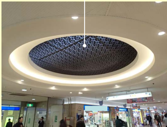
トップライト（自然排煙口）
