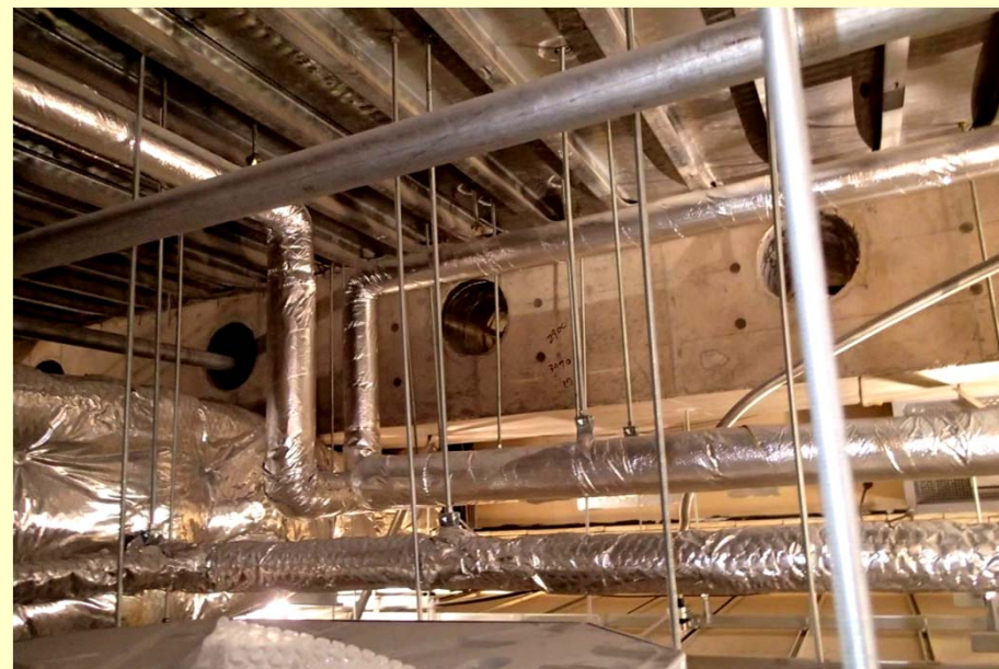
比較的新しい地下街の整然とした天井の内観（デッキスラブ）。
