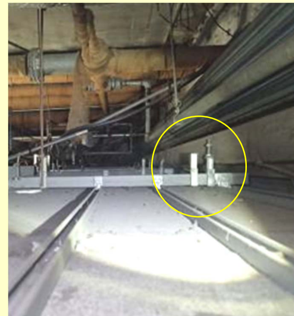
ハンガーに吊りボルトが取り付けられていない。
