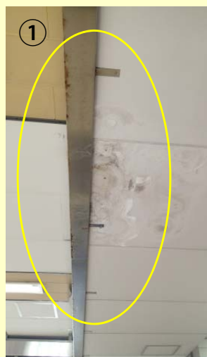
① EXP.Jカバー周辺の天井に漏水跡、錆が見られた。
