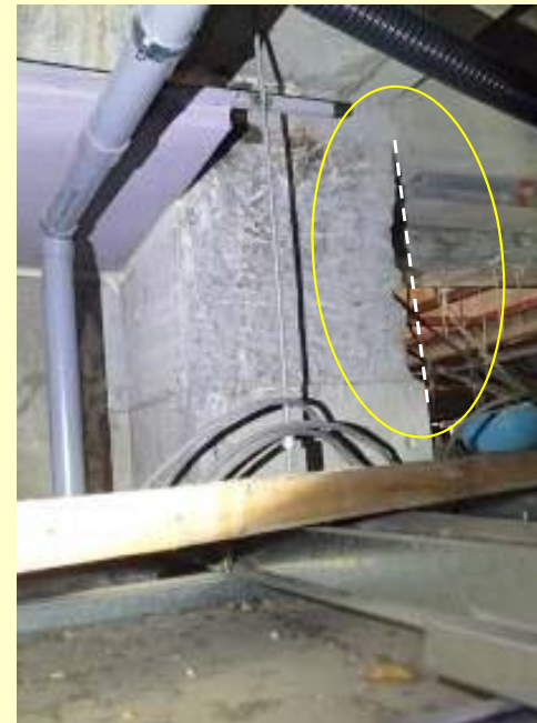
柱躯体のはつり跡。
