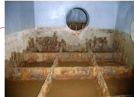
鋼製フーチング内部腐食状況
