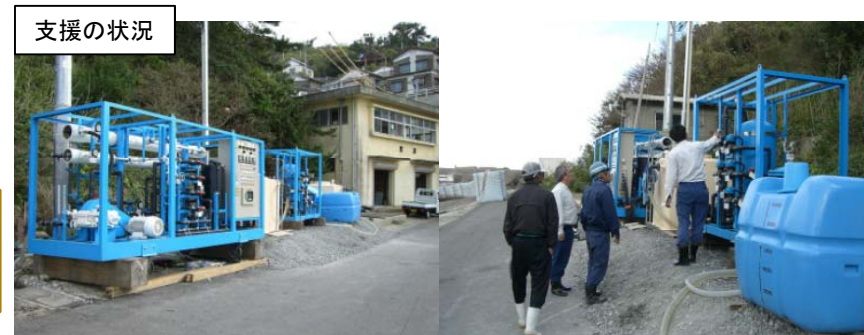
海水淡水化装置設置状況
