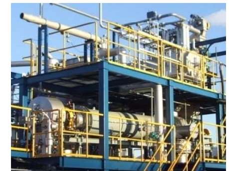
下水汚泥の炭化プラント
