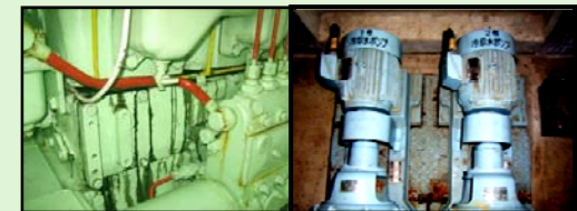
原動機のオイル漏れ
