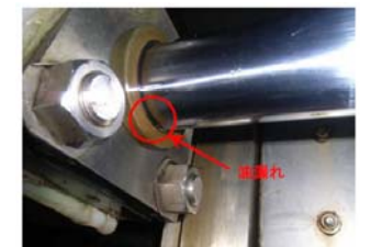
(右)点検結果の例 (ゲート設備における 油圧シリンダからの油漏れ)
