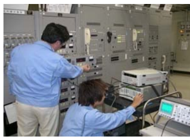
航空保安無線施設の点検
