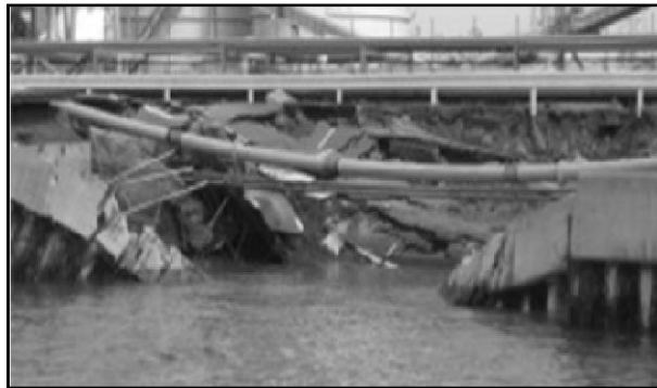
東日本大震災における港湾施設の被災
