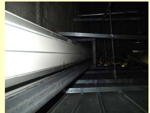
シャッター納まり 天井内懐 3.0m 改修により全て亜鉛メッキ部材天井下地
