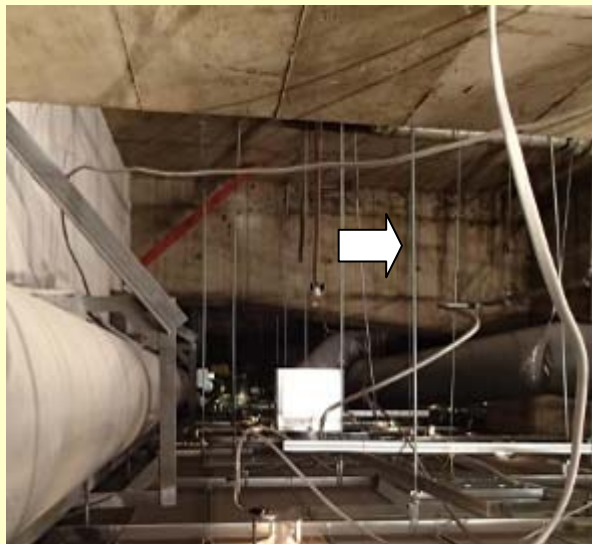
【振れ止めが設置されていない事例】
