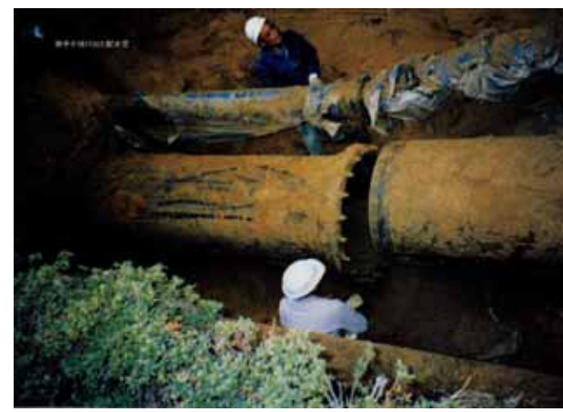
継手が抜き出た配水管
