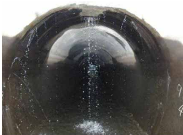
ひび割れからトンネル内部へ地下水が噴出
