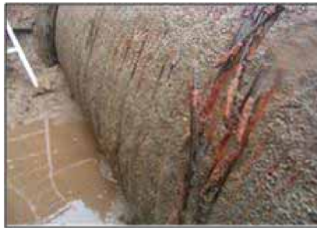
PC鋼線の破断
