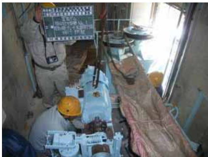
機械設備の更新
