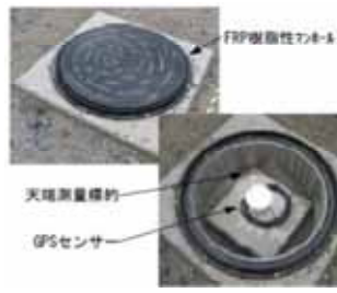
マンホール内に設置した GPSセンサー
