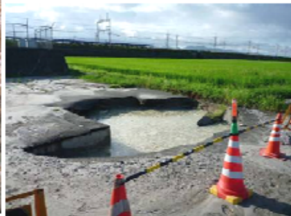
漏水による排泥工周辺陥没状況
