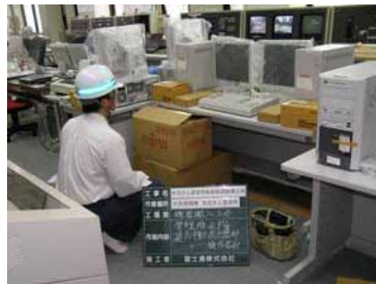
ダム操作機器の更新
