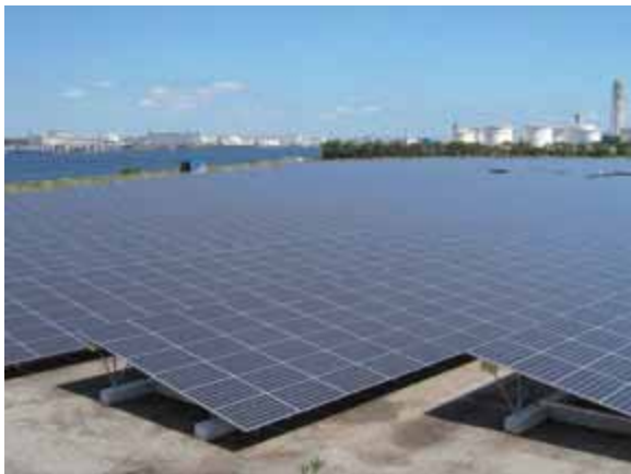
図表2-6-24 扇島太陽光発電所
