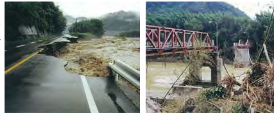
■平成12年東海豪雨時の道路崩壊や落橋の状況
